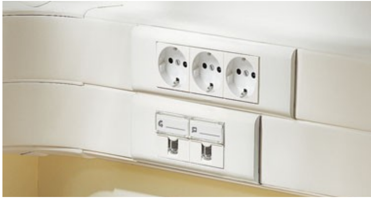
Εικ. 5.13. Πρίζες δικτύου και ρεύματος σε θέση εργασίας.
